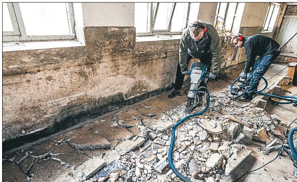
Testen foregik i en gammel ko-stald, hvor dele af betongulvet skulle brækkes op
