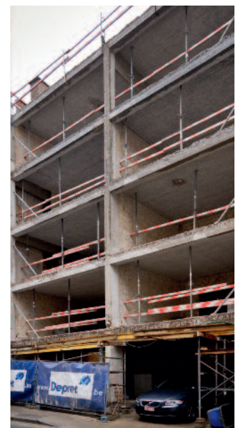
Die Sanierung eines Wohnkomplexes in Gent zählt für die belgische Firma Depret un den neuen Bosch-Elektro-Abbruchhammer GSH 27 VC Professional zu den eher kleineren Aufgaben.
